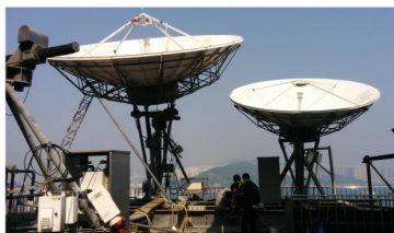
香港机房 楼顶的6米 和4.5米 天线
