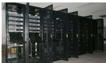
机房中的 机柜
